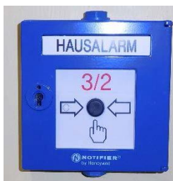
Druckknopfmelder für den Feueralarm
